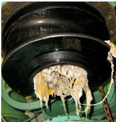
Tubería atascada debido al uso de toallitas
