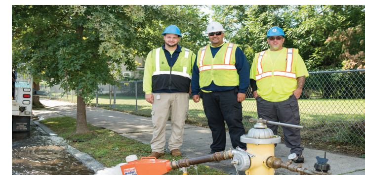
Nuestro equipo de trabajo y servicio, mantiene más de 500 millas de tuberías y más de 6,000 bocas de riego dentro del sistema de distribución en Springfield y Ludlow.
