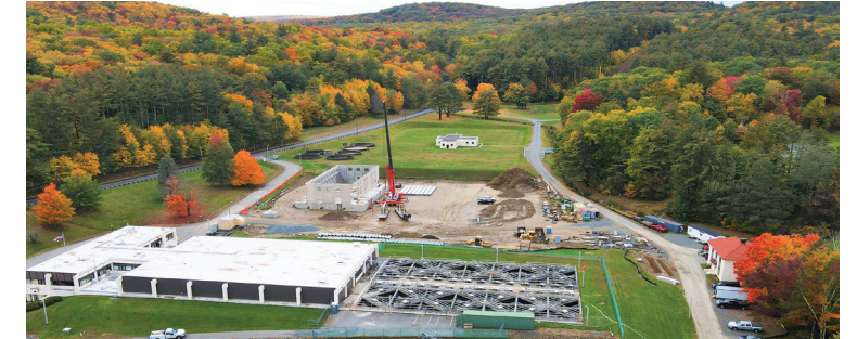
Construcción de la Fase 1: El nuevo pozo Clearwell bajo construcción en la planta de tratamiento de agua West Parish Filters en octubre de 2022.
