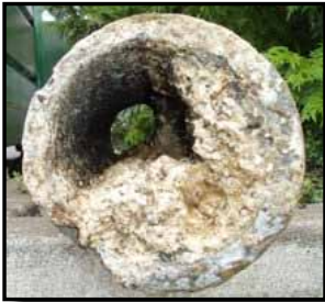
Grasas atascadas en una tubería de alcantarilla
