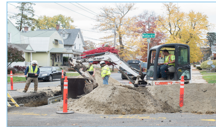
Los equipos de la Comisión reemplazan una tubería principal de agua en la Calle Milford en Springfield. (Ver arriba). El financiamiento de WIFIA apoyará proyectos de mejora de tuberías principales de agua adicionales dentro del sistema de distribución.
