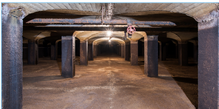
En la foto de arriba hay un filtro de arena lento de la década de 1920, todavía en uso hoy en día para satisfacer la demanda máxima. Todos los filtros de arena lentos se eliminarán en la construcción de la nueva planta de tratamiento.
